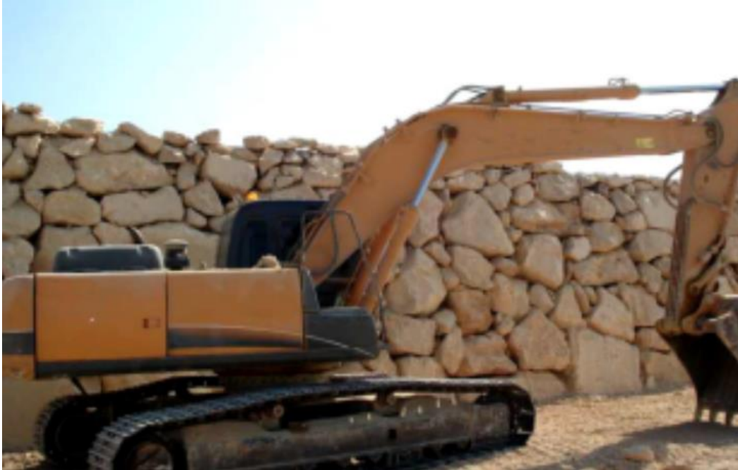
Imagen 1.- Excavadora hidráulica de orugas utilizada por el operario autónomo en la ejecución del muro de escollera.
