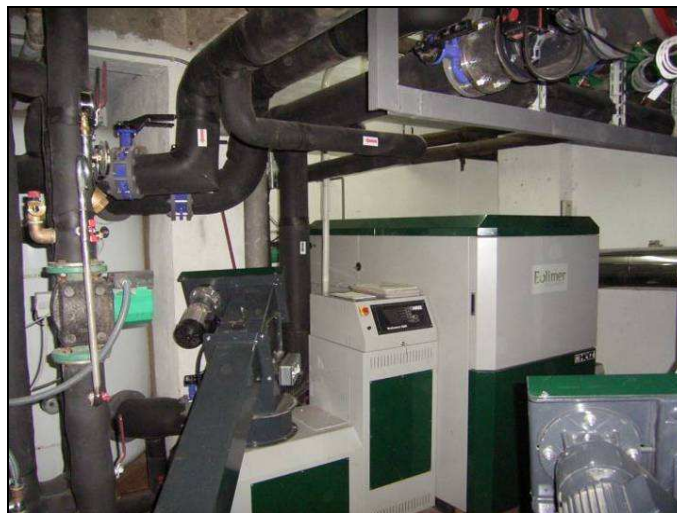
Figura 3. Caldera de pellets en comunidad de vecinos. Foto: Eolimer Renovables, S.L..
