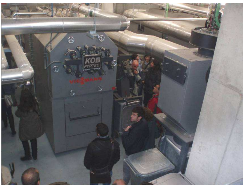
Imagen 1. Nuevas calderas biomasa de la cooperativa de calefacción San Juan Bautista en el barrio Lourdes de Tudela.
