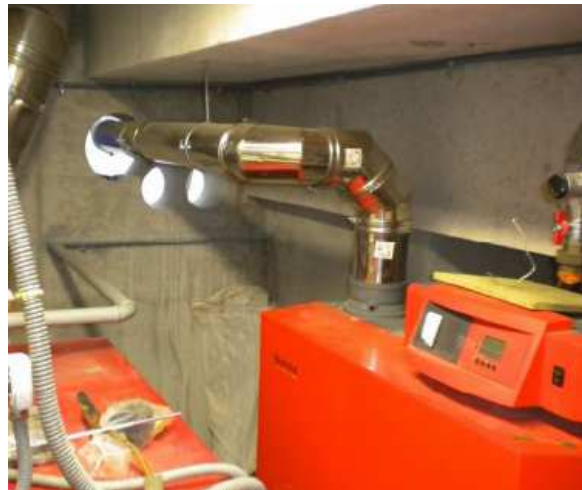
Imagen 8. Imagen de instalación de caldera en Lekunberri.
