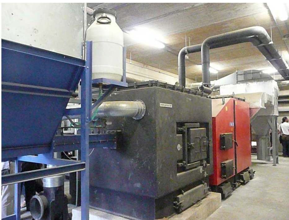
Imagen 4. Calderas de la red de calor municipal de Larraintzar (Ultzama)
