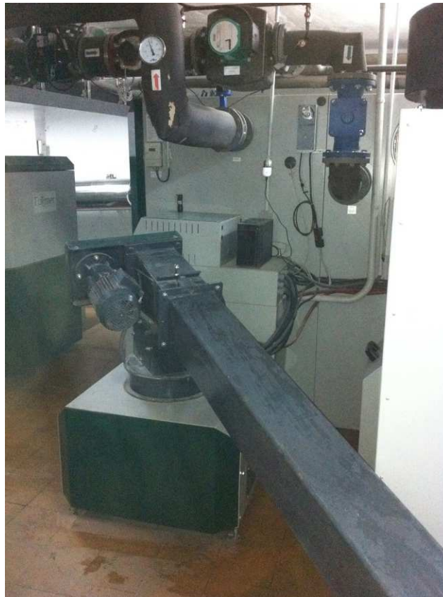
Imagen 10. Caldera de la Comunidad de vecinos de la Avda. Bayona, 37-39.
