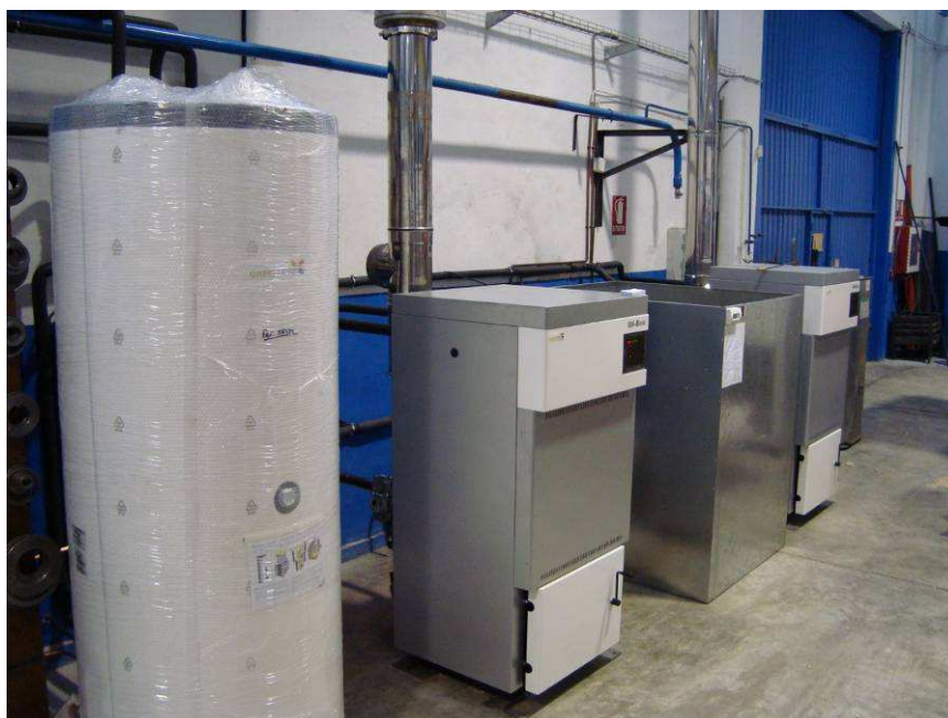
Imagen 32. Instalación de Promosal. Pamplona
