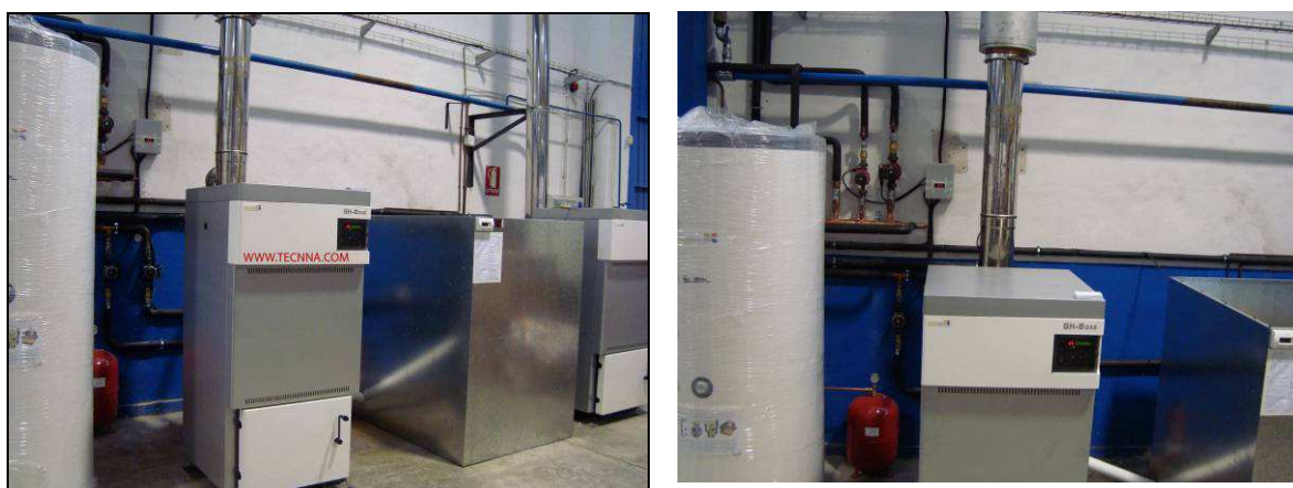
Imagen 31. Instalación de Promosal. Pamplona
