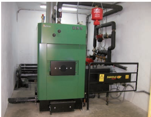
Caldera de biomasa instalada en el Parque Natural del Señorío de Bértiz. Foto cedida por el Departamento de Desarrollo Rural y Medioambiente.
