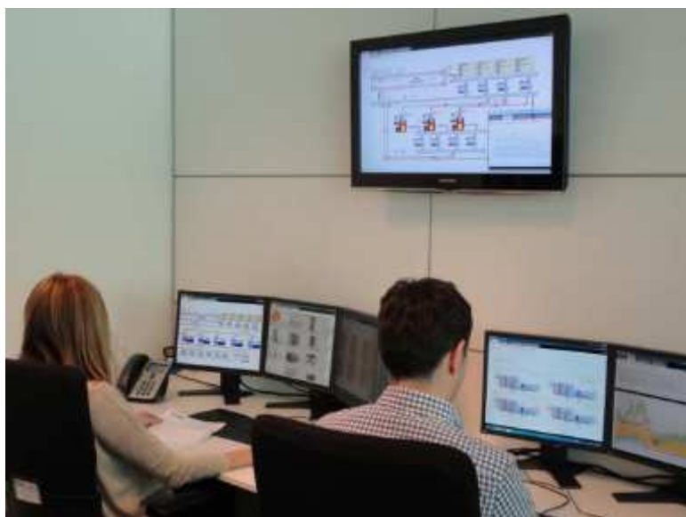
Figura 9. Centro de Control de Edificios de Acciona
