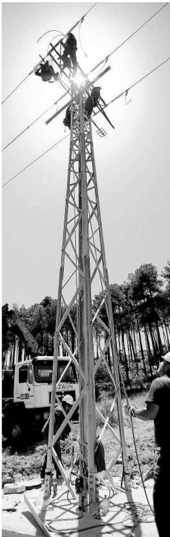
El equipo de Manuel Álava trabaja en el montaje de la torre.
