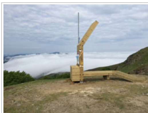
Una muestra de la red de antenas instalada para mejorar la comunicación entre los equipos de emergencias.
