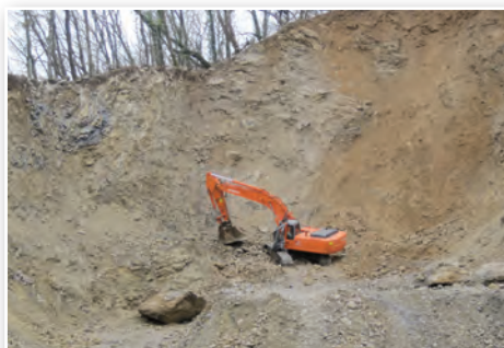
Roca caída causante del accidente
