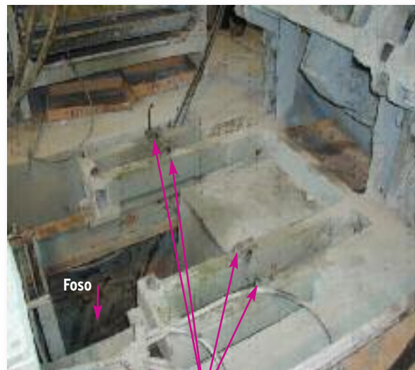
Anclajes inferiores de los cilindros retirados después del accidente
