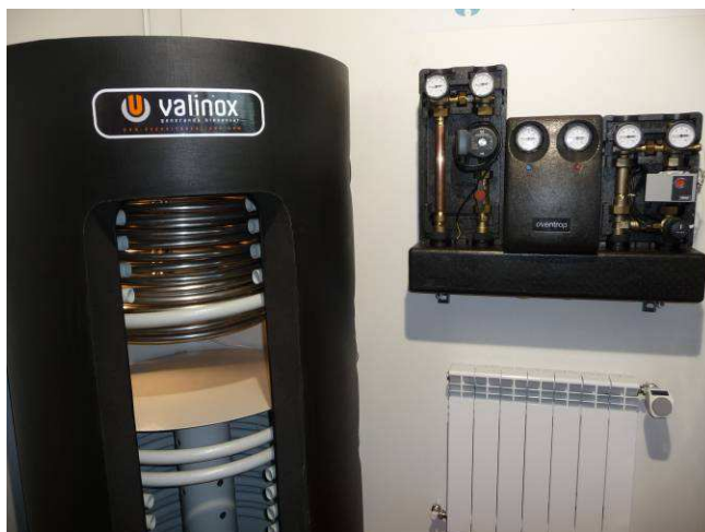
Figura 5. Caldera de biomasa.
