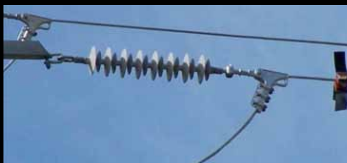
FIG. 14: CADENAS DE AMARRE CON 1 M DE AISLAMIENTO EFECTIVO UTILIZABLES EN LOS TENDIDOS DE DISTRIBUCIÓN QUE DISCURRAN POR LA NUEVAS ZONAS DE PROTECCIÓN PARA LAS AVES EN NAVARRA (RD 1432/08). EN CASO NECESARIO, COMO EN LA FOTO (ZONA DE INTERÉS PARA AVES ESTEPARIAS), LOS TENDIDOS ESTARÁN ADEMÁS CONVENIENTEMENTE SEÑALIZADOS.
