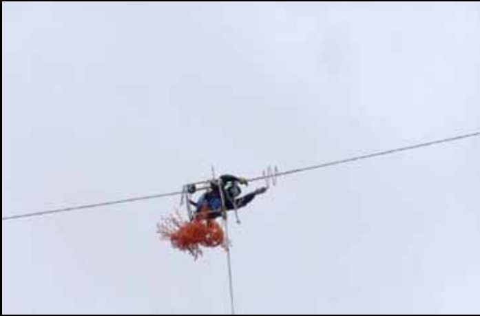
FIG. 5: SEÑALIZACIÓN DE LOS HILOS DE TIERRA EN UN TENDIDO DE TRANSPORTE (220 KV). BALIZAS SALVAPÁJAROS (ESPIRALES CERRADAS DE PROPILENO) COLOCADAS A MANO MEDIANTE CARROCÍN COLGADO.
