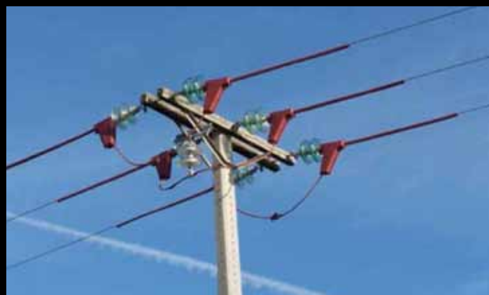
FIG. 4: APOYO DE AMARRE CORREGIDO DE ACUERDO CON LA NUEVA NORMATIVA ELECTROTÉCNICA (RD 1.432/08). NÓTESE LA REINSTALACIÓN DEL PUENTE FLOJO CENTRAL SUSPENDIDO, EL AISLAMIENTO CON CUBIERTAS DE SILICONA DE 1.5 M DE CONDUCTOR A AMBOS LADOS DE LAS CADENAS DE AMARRE Y LA PROTECCIÓN DE LAS GRAPAS DE AMARRE CON CUBREGRAPAS PREFORMADOS.
