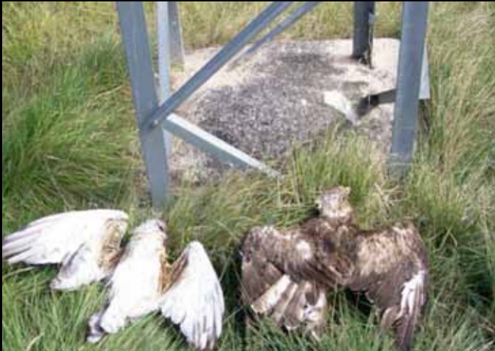
FIG. 1: PAREJA DE CULEBRERAS EUROPEAS ELECTROCUTADAS EN UN APOYO DE AMARRE DE UN TENDIDO DE DISTRIBUCIÓN DE TIERRA ESTELLA. EL TENDIDO FUE CORREGIDO EN 2010.
