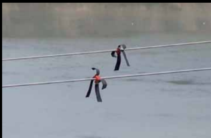
FIG. 8: TENDIDO DE DISTRIBUCIÓN CON LOS 3 CONDUCTORES SEÑALIZADOS MEDIANTE BALIZAS SALVAPÁJAROS ("X" DE NEOPRENO) PARA EVITAR ACCIDENTES POR COLISIÓN EN EL CRUZAMIENTO DEL RÍO EBRO.
